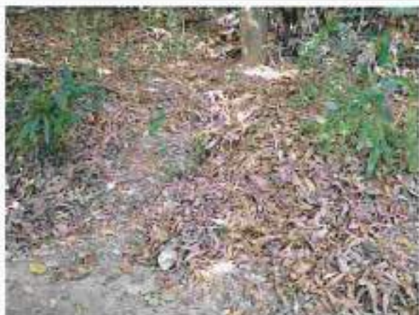
地點14 位於興林段1049地號東側邊坡目前維持現狀，將持續追蹤。
